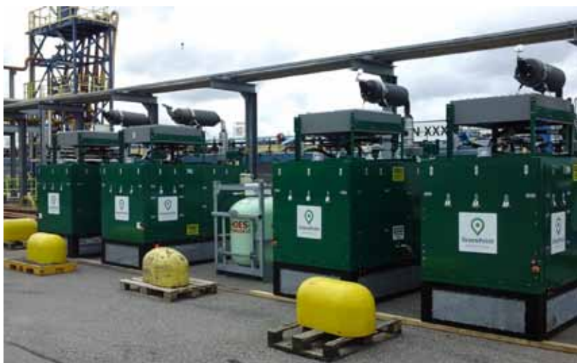
Een installatie van Greenpoint kan ook ingezet worden voor het ontgassen van opslagtanks (bron: Greenpoint Maritime Services)
